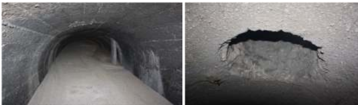
Img. 10.- Zona colapsada por filtraciones de hormigón y conducto de ventilación en bóveda. Año 2014.
