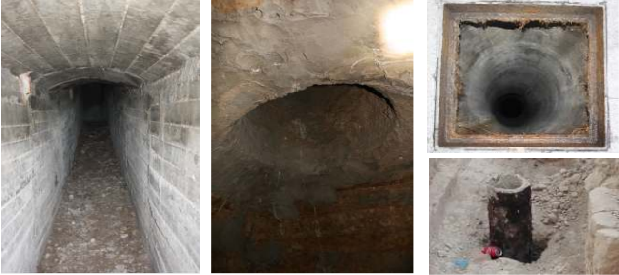
Img. 11.- Galería e instalaciones existentes: sistema de ventilación natural en la bóveda; Salida a superficie (arqueta en Plz. de Baix); Refuerzo superior de tubo metálico (Plz. Menéndez y Pelayo).
