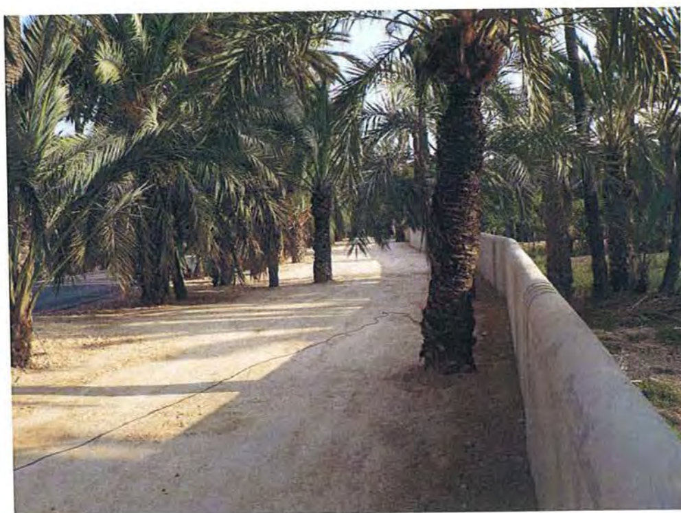
Año 2006.- El muro de cierre al Camino del pantano se ha desplazado hacia el interior del huerto rellenando las teselas de borde. (¿?)
